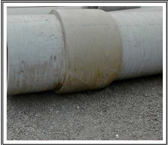
La reparación No requiere el cambio de la tubería
