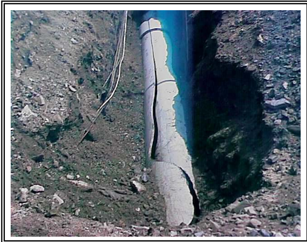
La reparación si requiere el cambio de la tubería
